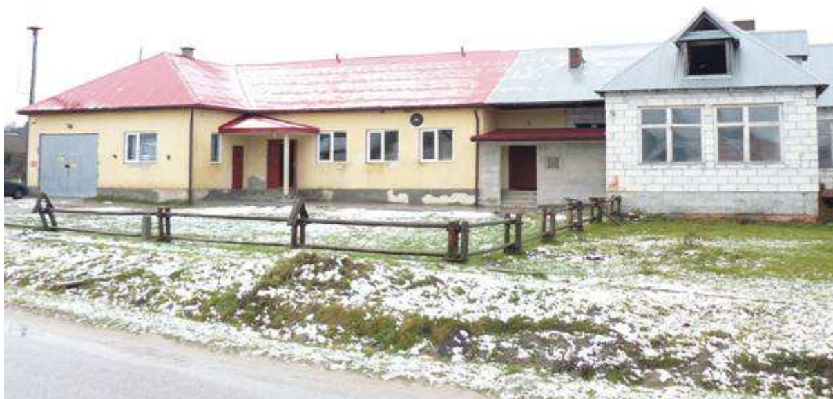
Zdjęcie 5. Budynek remizy OSP wraz z nowo dobudowaną częścią, planowaną na świetlicę wiejską (stan surowy)
